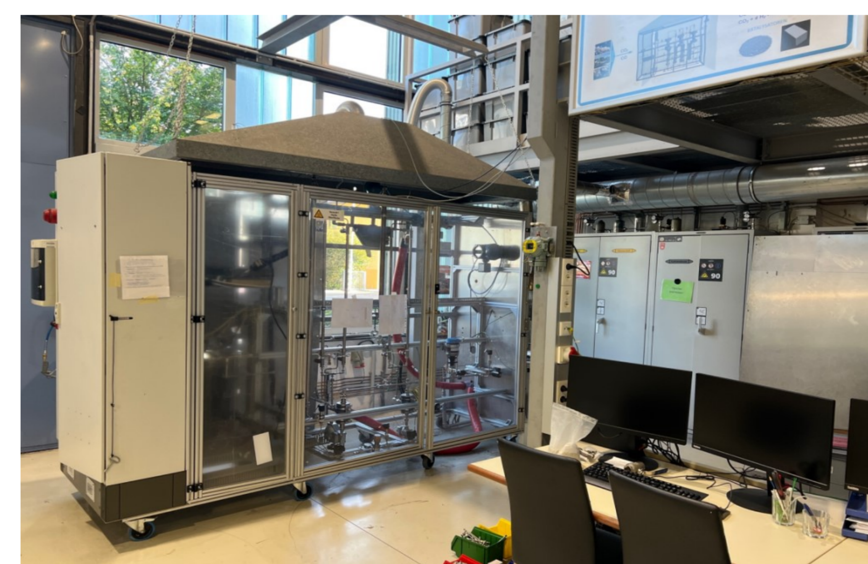
Abbildung 3: Überarbeitete Labormethanisierungsanlage am Lehrstuhl für Verfahrenstechnik des Industriellen Umweltschutzes, Montanuni Leoben
