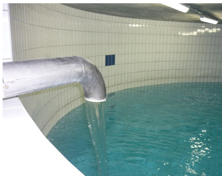
Hochbehälter © Wasserverband Grazerfeld Südost
