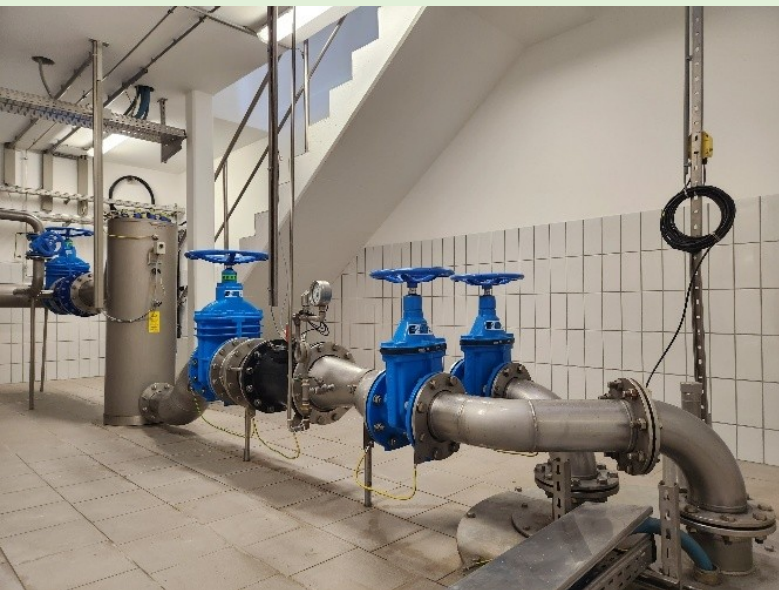
Brunnen Kalsdorf © Wasserverband Grazer Umland
